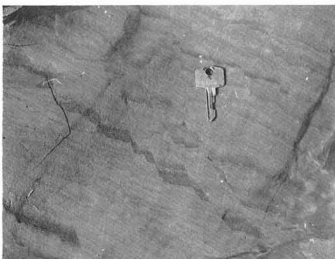
FIG. 14 - Argille siltose grigie laminare interessate da alcune piccole faglie (tratto 2 della colonna stratigrafica).
