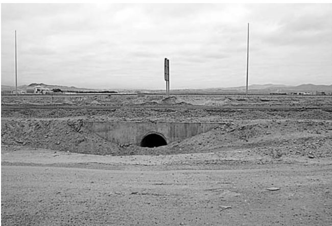
FIG. 14. - Caldera: drenaje de Quebrada Blanca en Ruta Internacional 5, con su exutorio represado y sin trabajos de mantenimiento.
