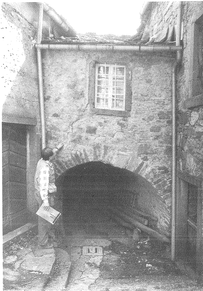
FIG. 6 - Edifici di Chioso danneggiati dai movimenti di massa; in particolare, si notano le deformazioni della volta del sottopasso e della finestra sovrastante.
