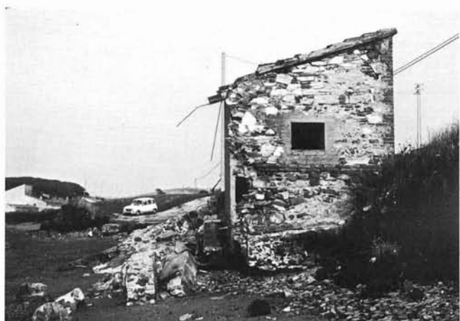
FIG. 15. - La stessa casetta ripresa nella fig. 14, parzialmente demolita dalle onde, come si presenta nel Marzo 1983. A sinistra è visibile ancora la fondazione del muro perimetrale lato mare crollato sotto l'azione delle onde. La finestra sulla facciata è stata aperta successivamente al 1970, dopo il crollo del muro perimetrale lato mare, al fine di utilizzare la parte ancora rimasta in piedi.
